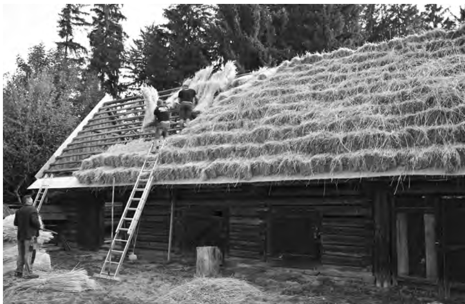
Obr. 3. Kladenie slamených snopov na strechu združenej hospodárskej stavby usadlosti z Vyšného Kubína. Foto J. Neplech, 2018
